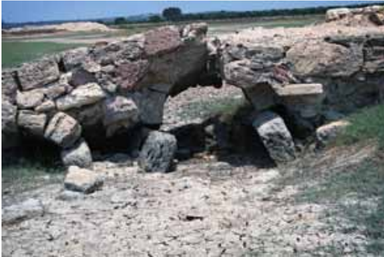
Köprü'nün yıkık durumdaki kemerlerinden birinin görünümü
