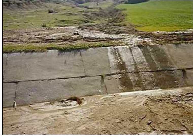
Şekil 6. 25. Sanat Yapısı Bulunmaması Nedeniyle, Sulama Kanalına Yüzeysel Sular ve Tortu Girişi
