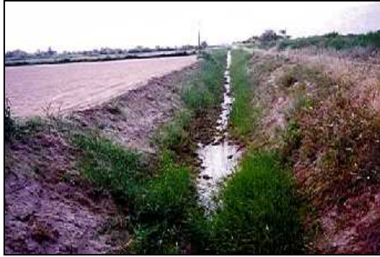
Şekil 6.27.Boşaltma Kanalına, Kanal Kenarındaki Kamulaştırılmış Alanların Sürülmesi Sonucu Tortu Girişi
