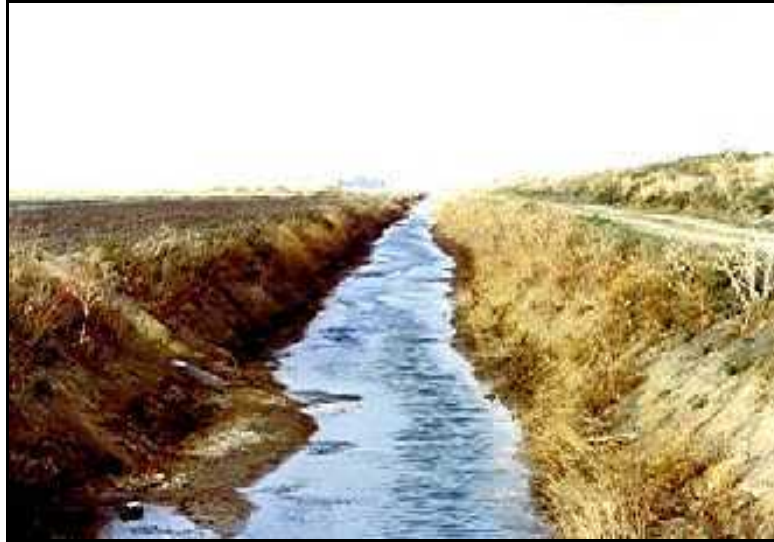
Şekil 6.26.Boşaltma Kanalına, Sanat Yapısı Bulunmaması Nedeni ile Tortu Girişi
