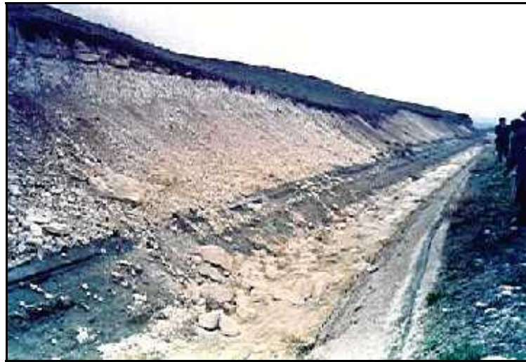
Şekil 6. 18. Yaralı Sulaması Sağ Ana Kanalında Şev Akmasının Yoğun Olduğu Bölümün Görünüşü (107)
