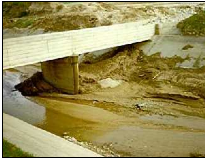
Şekil 6.24.Sulama Kanalına, Üst Sel Geçidi Çevresinden Tortu Girişi
