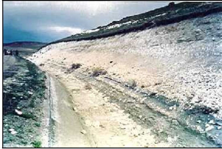
Şekil 6. 19. Yaralı Sulaması Sol Ana Kanalında Şev Akmasının Yoğun Olduğu Bölümün Görünüşü (107)
