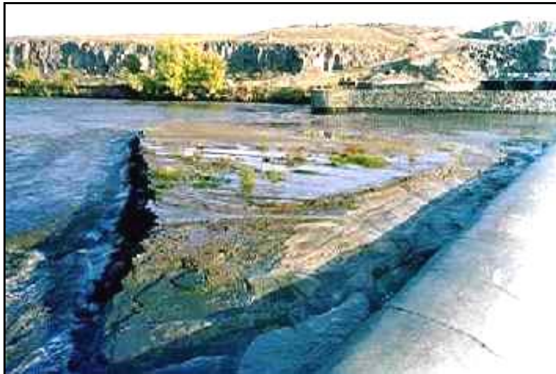
Şekil 6.20. Iğdır Sulaması Serdarabat Regülatörü Dolu Gövde Membaındaki Sürüntü Malzemesinin Görünüşü (105)
